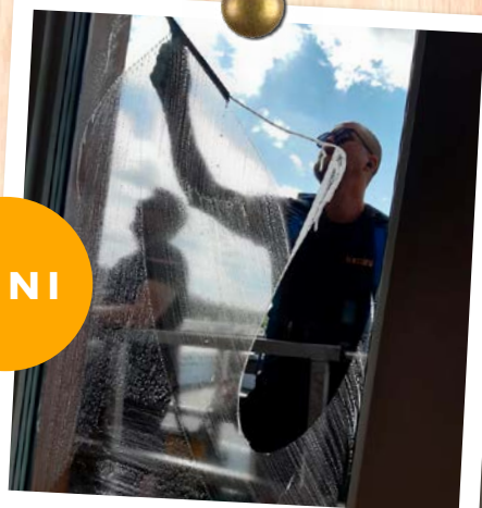
Skinande fönster på Turebergshuset
